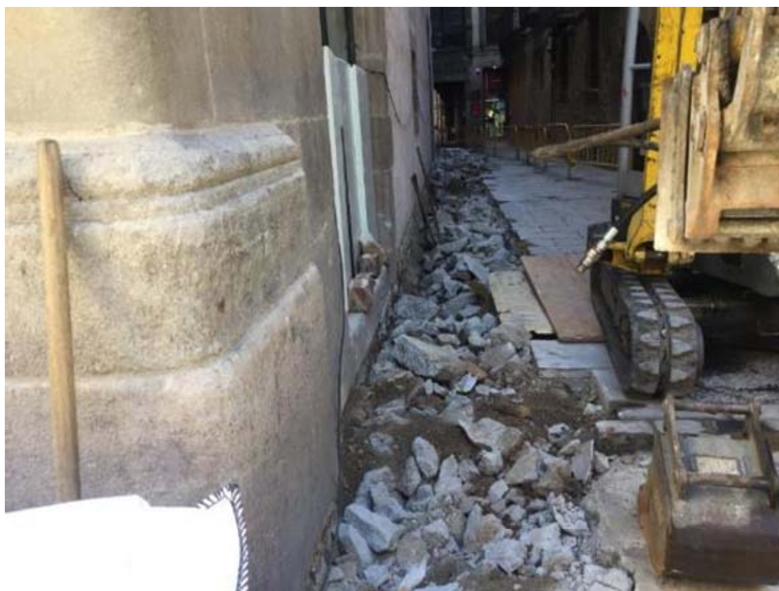
Foto 15: tram de rasa del carrer del Bisbe Caçador tot picat.
